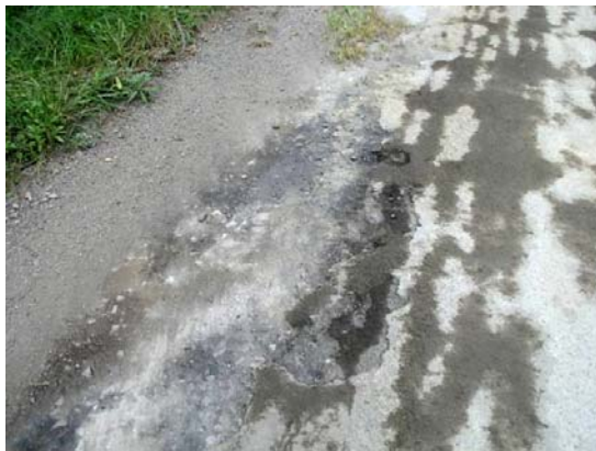
Pothole at edge
